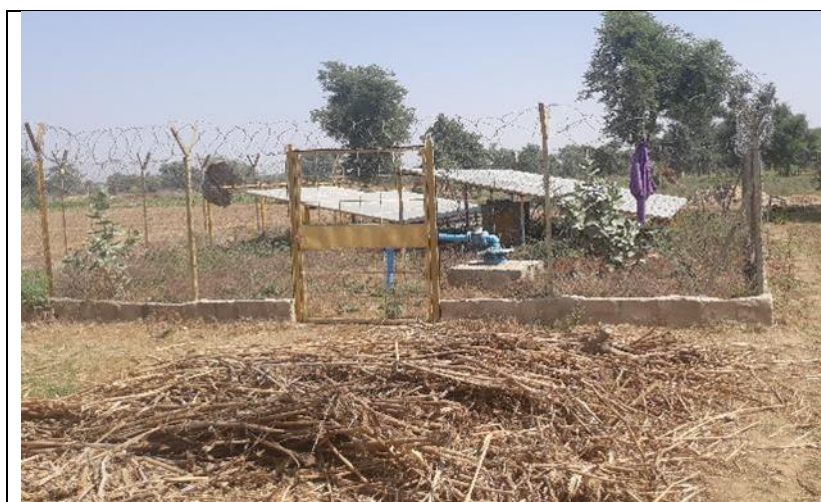
Installation solaire réalisée pour irriguer 4 ha à Soumarana
