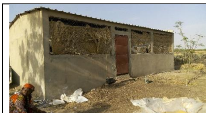
Muret beaucoup trop haut, paroi grillagée de taille insuffisante pour une bonne ventilation.
