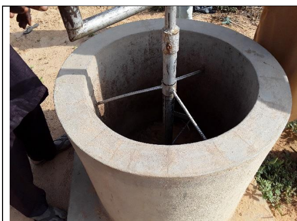
Photo 2 : Cuve d'entrée de la matière première
