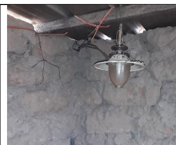
Photo 8 : Ampoule à Biogaz
